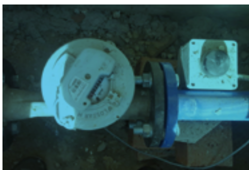
Contadores con telemedida
